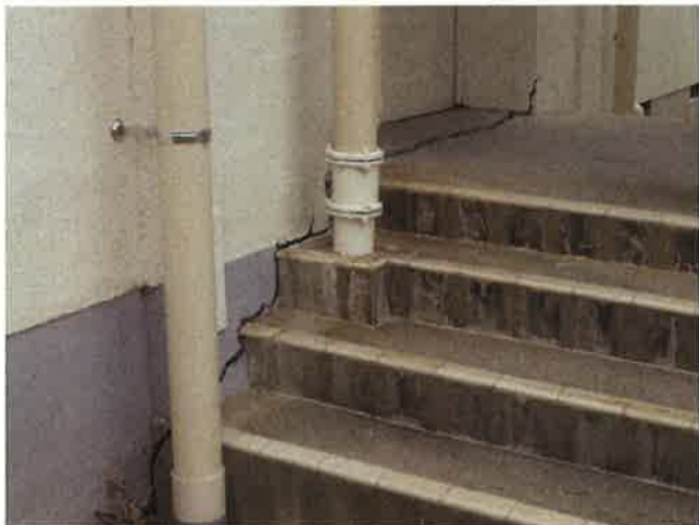
外壁クラック
