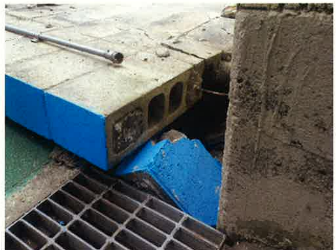
崩壊部（コンクリートブロック側）
