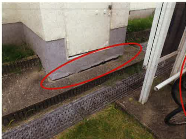
柱脚部クラック
