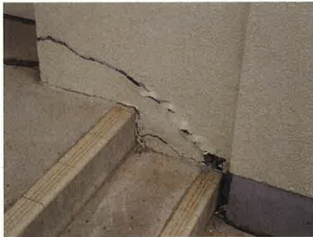
外壁クラック
