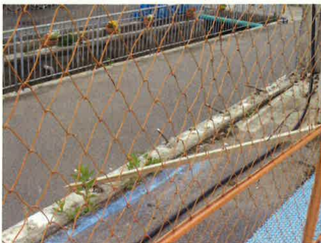
崩壊部（基礎側）
