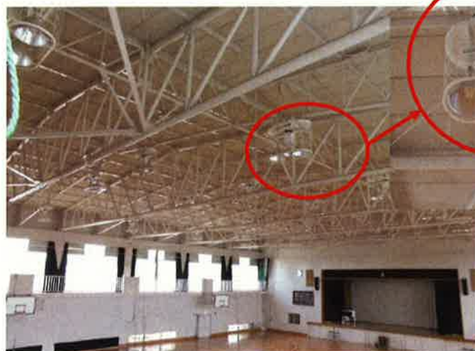
体育館照明器具（水銀灯）
